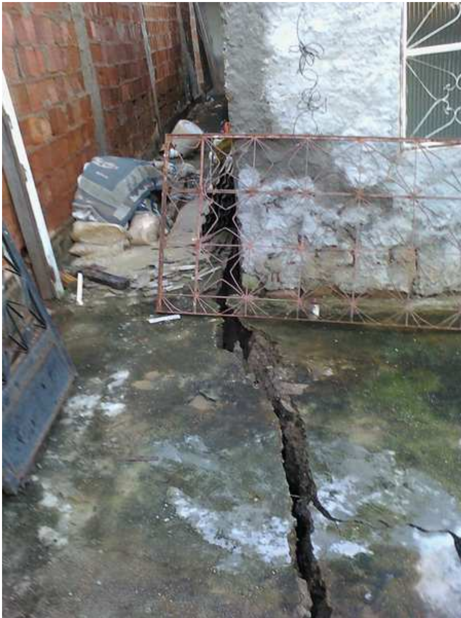
Foto 05 – trinca que se abriu atrás de uma das casas em face do rastejo.
