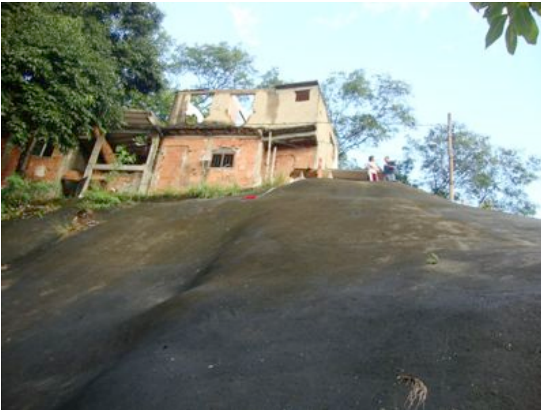
Foto 13 - Notar casa protegida pelo revestimento em concreto projetado sendo demolida pela Prefeitura
