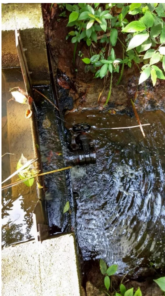
Figura 14 – Tubulação por baixo do solo do Igarapé Mutum.
