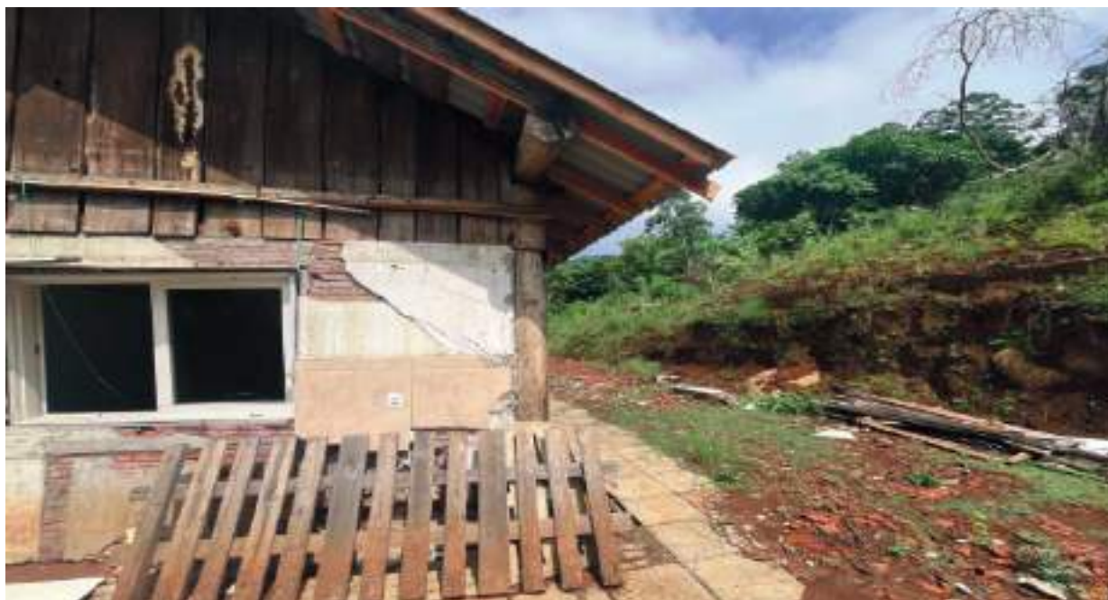
↑ Danos gerais na estrutura da Roça – casa dos Orixás devido aos movimentos de massa pelas chuvas e inundações, município de Feliz, em visualização após 8 meses das enchentes. © Anistia Internacional Brasil.
