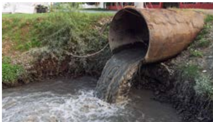
Figura 4. Esgoto a céu aberto. (Fonte: FLUXO, 2021.)
