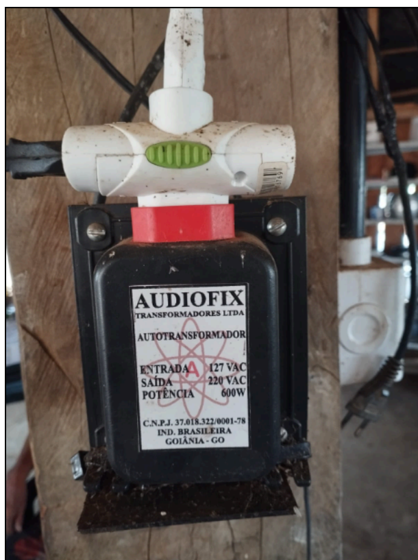
Figura 7. Transformador 127/220 V instalado nas residências de madeira e palha da Aldeia Khikhatxi.
