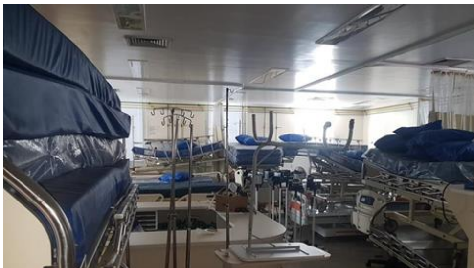
Unidade de Urologia com mofo e infiltração.
